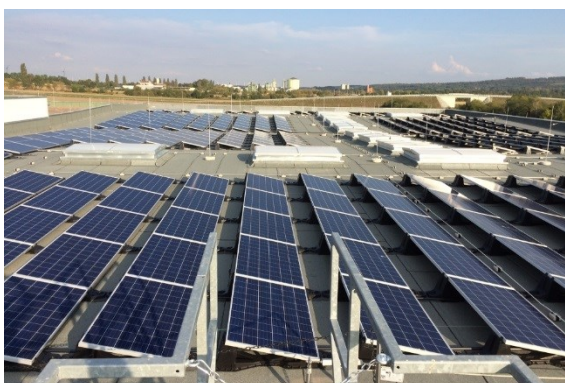
PV-Anlage am Dach des Bauder-Werkes Wilfleinsdorf Foto: Fa. Bauder
