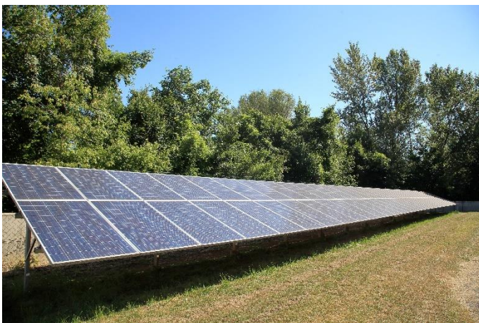
Abbildung 48: PV-Anlage Scharndorf /Quelle: Barbara Krobath®
